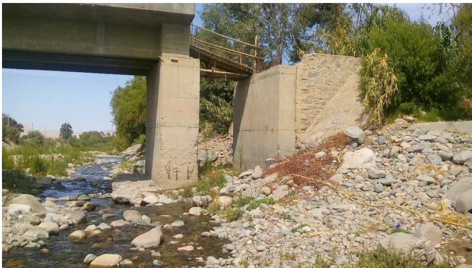
Figura 13. Enrocado antisocavante expuesto por socavación general del río.
