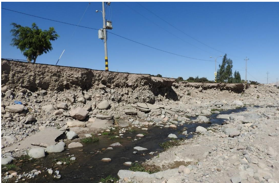
Figura 5. Sector de vía Colapsado a consecuencia de Erosión. Se aprecia tramo de la obra de protección o encauzamiento fallado, debido a los ingresos de avenidas en temporada de lluvias. Estas estructuras generan una falla en cadena.
