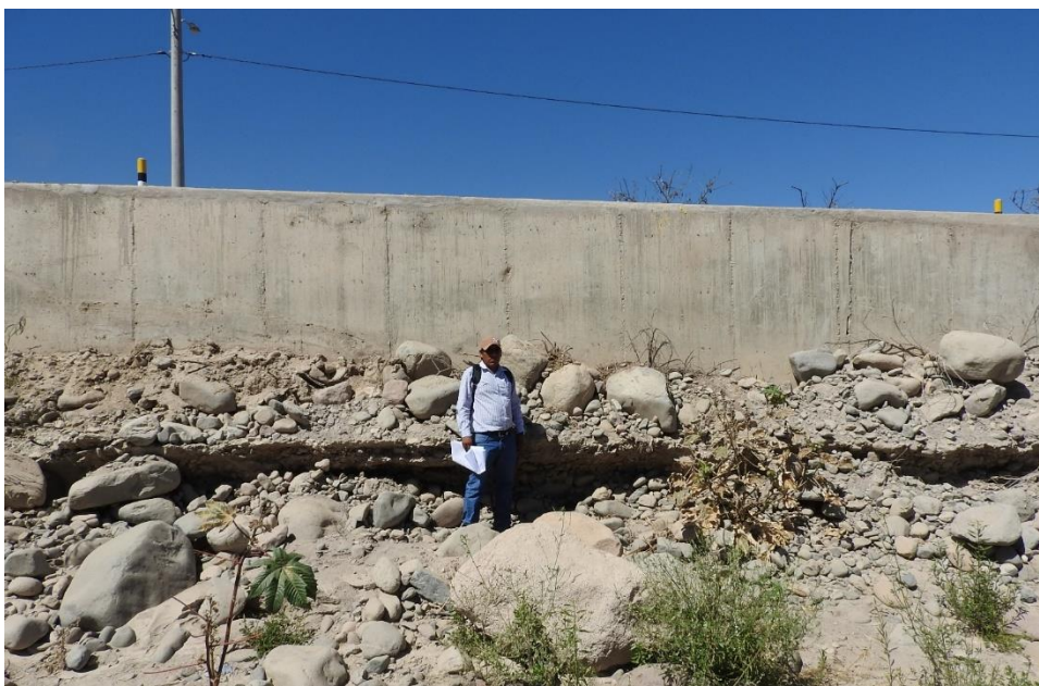
Figura 6. Cimentación de Expuesta en Muro de Protección Muro de Contención – Encauzamiento de concreto armado con la cimentación expuesta debido a la socavación. Ante nuevos ingresos de avenidas esta estructura colapsaría, generando una falla en cadena sobre las estructuras que la preceden y continúan.
