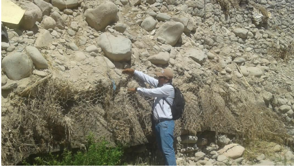
Figura 19. Colchón Antisocavante expuesto Falla del Sistema de Protección en el cauce del Río Tumilaca (Margen Izquierda)
