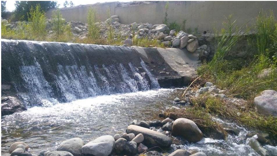
Figura 17. Poza de disipación fallada en barrage, prog. 2+220
