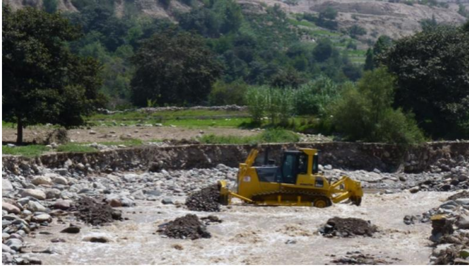
Figura 3. Terreno de Cultivo erosionado a consecuencia del Ingreso de Avenida Fuente: http://www.radionacional.com.pe/informa/nacional/limpian-el-cauce-del-r-o-moquegua-para-evitar-nuevos-desbordes
