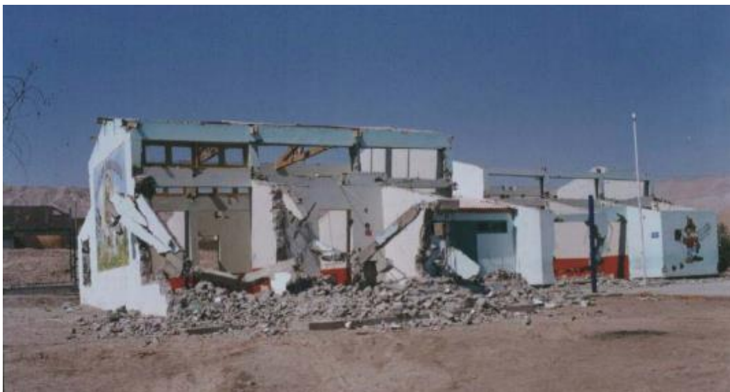
Figura 4. Vista del CEI de San Antonio que colapsó en el 2001.
