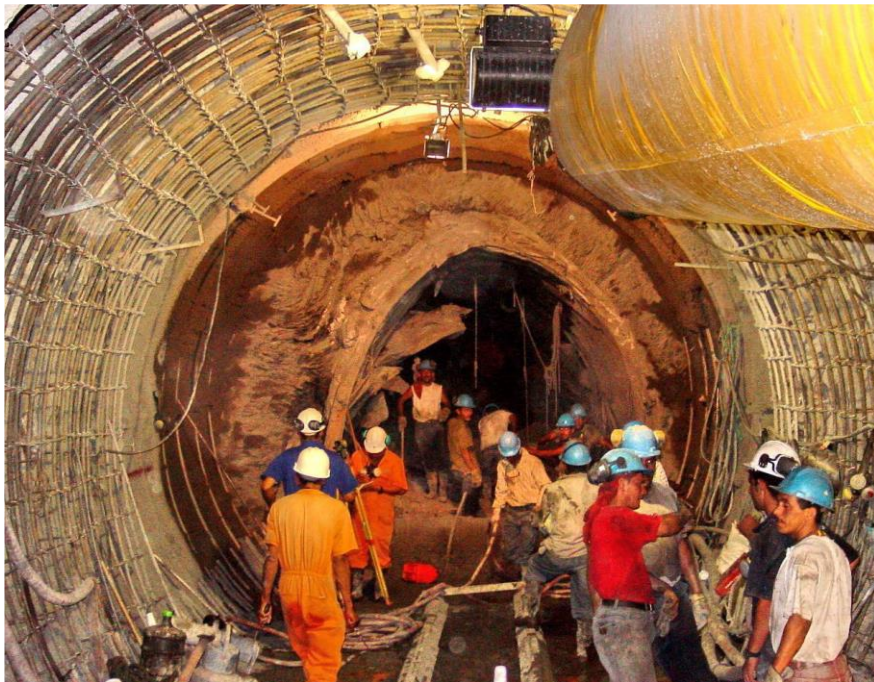
Figura 97. Fallo por squeezing en el túnel de Yacambú-Quivor (Venezuela) Fuente: Hoek & Marinos, 2009
