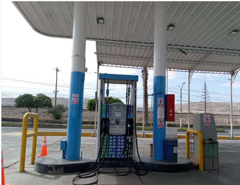
Figura 3 Surtidor Gilbarco 1, cuenta con ocho mangueras
