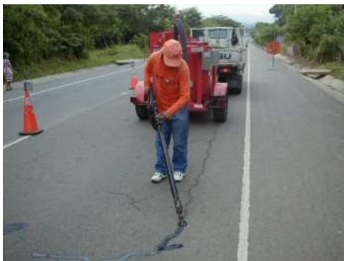
Figura 20. Colocación del material sellante dentro de la grieta o fisura Fuente: Alonzo, 2012
