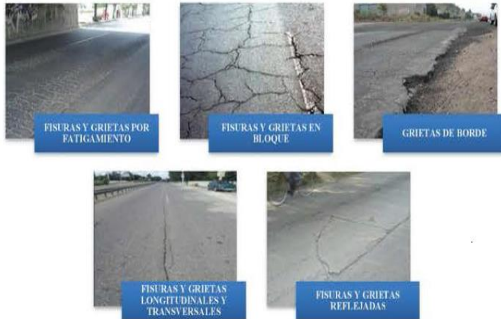
Figura 3. Fisuras y grietas en pavimentos flexibles
