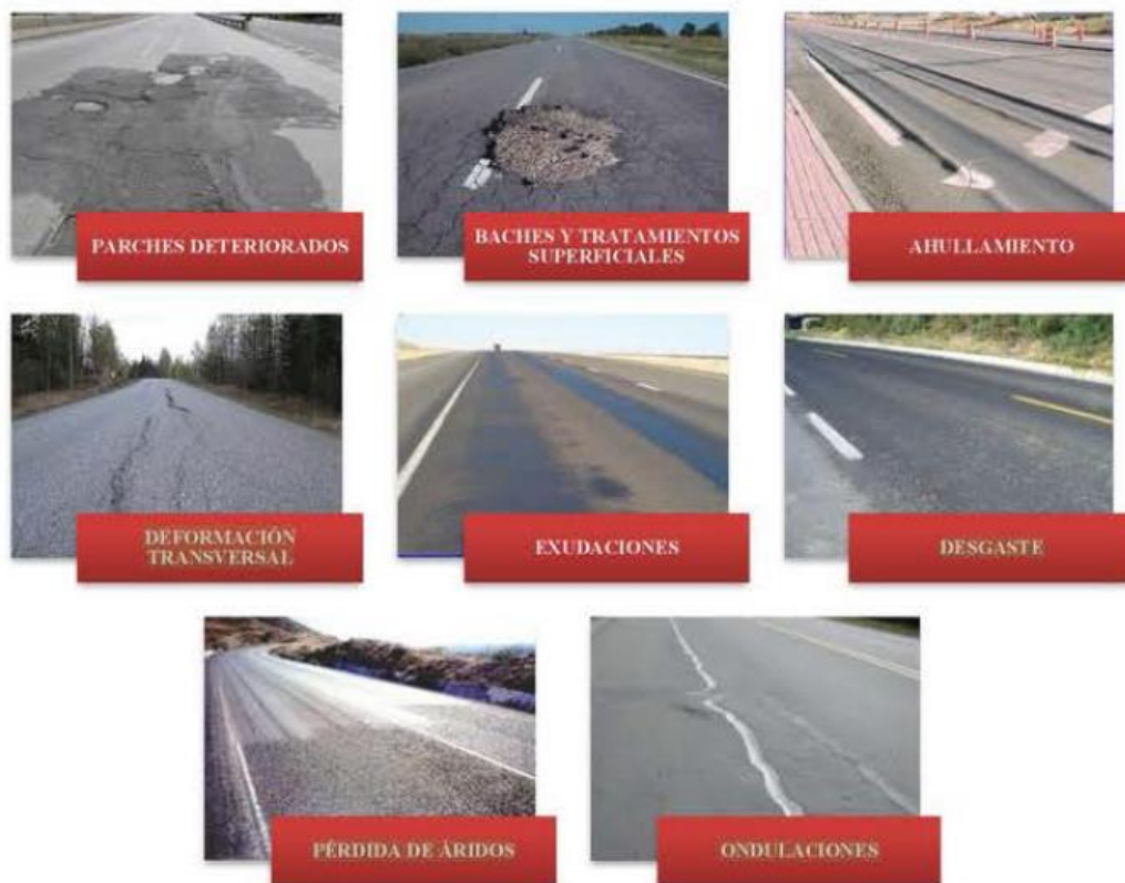
Figura 4. Deterioro superficial en pavimentos flexibles
