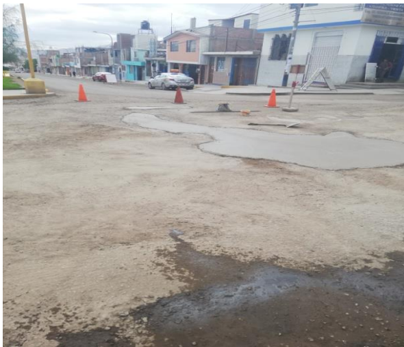
Figura 8. Daños que comprometen la estructura del pavimento. Av. Santa Fortunata.
