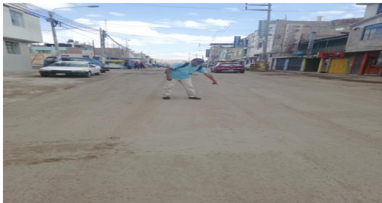
Figura 10. Carpeta asfáltica desgastada
