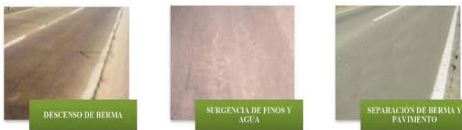
Figura 5. Otros deterioros en pavimentos flexibles
