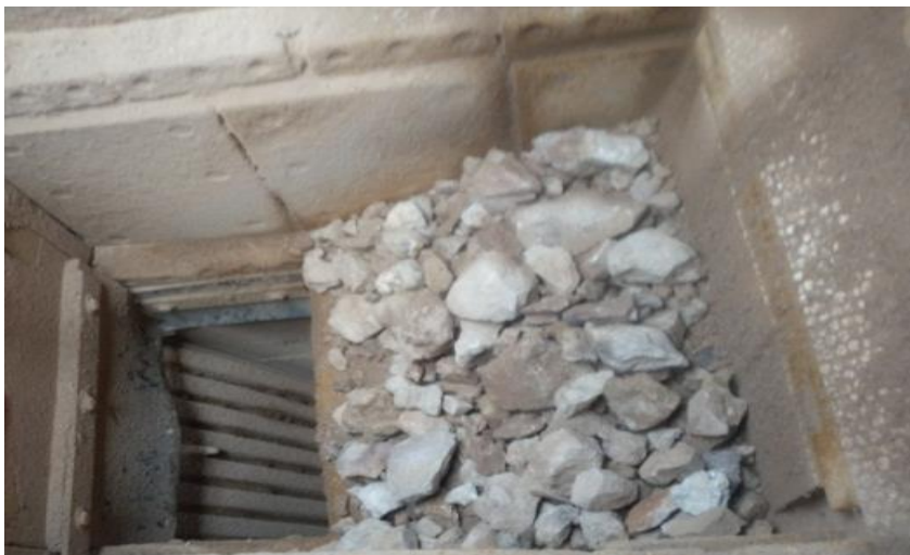
Figura 8. Linnners Cerámicos Instalados en las Paredes del Chute de Descarga
