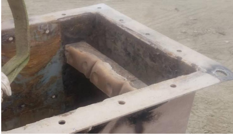
Figura 9. Erosión en los ladrillos de impacto de T1
