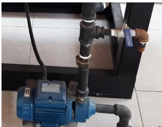
Figura 29. Válvula de cebado se encuentra muy cerca al motor de la bomba.
