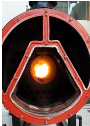
Figura 17. Interior de la caldera pirotubular.
