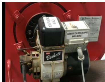
Figura 14. Quemador Beckett de la caldera Pirotubular.
