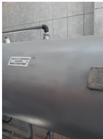
Figura 22. Tanque de condensado.
