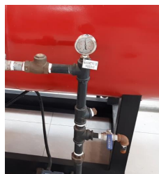
Figura 27. Manómetro marcando un correcto funcionamiento.
