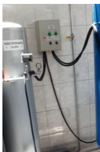
Figura 18. Liberación de vapor muy cerca a tablero eléctrico.
