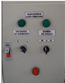
Figura 23. Tablero eléctrico de la caldera.
