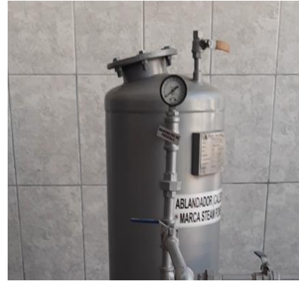
Figura 44. Presión en el tanque de ablandamiento.
