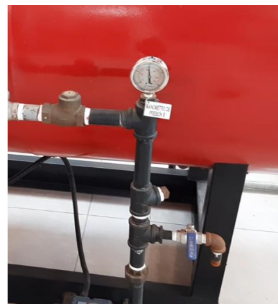
Figura 42. Presión de alimentación de agua a la caldera.
