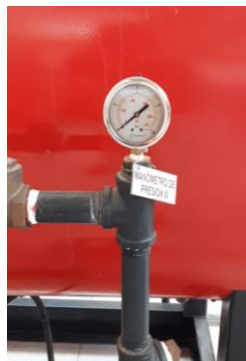
Figura 26. Manómetro mostrando cavitación de la bomba.
