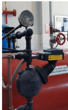
Figura 24. Nivel por boya de la caldera Pirotubular.
