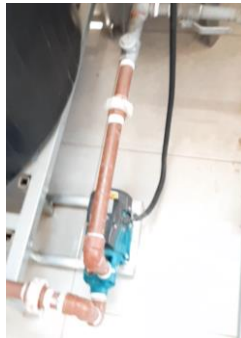
Figura 35. Bomba de alimentación de agua al Tanque Hidroneumático.
